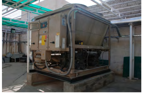
مشروع تحديث منظومة تبريد الحرم المقدس
